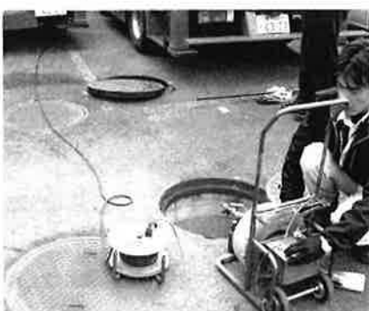
汚水管トラブルの原因を調べると……
